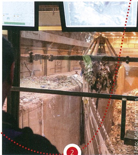
Blick aus der Krankanzel in den Müllbunker der EGK: Rund sechs Tonnen Müll packt der Greifer bei jedem Umladen.
